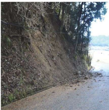
施工前：斜面崩壊
