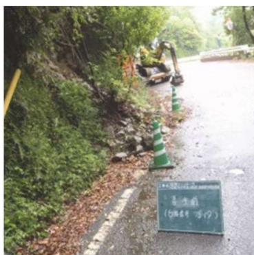
小規模崩壊の状況
