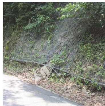
落石防護網裾のこぼれ出し状況
