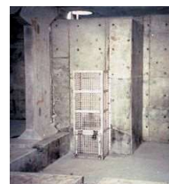
●堆砂部・越流壁・オリフィス・スクリーン
